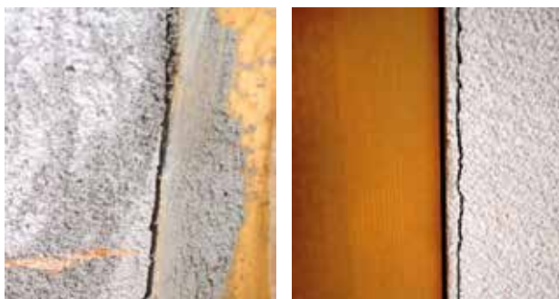
Crepe tra controtelaio e muro nella parte interna.
